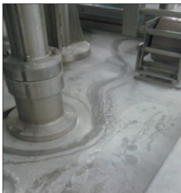
Рис. 2. Отложение солей жесткости воды на поверхности станины фасовочного автомата
